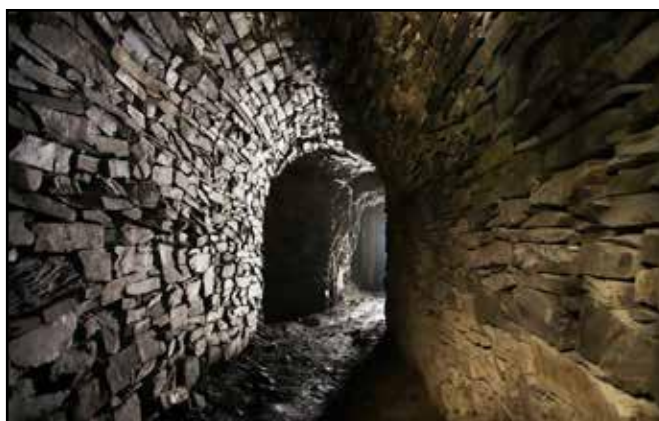
Vyskládaná chodba v místě původního větracího okna ve štole Nový Svět B
