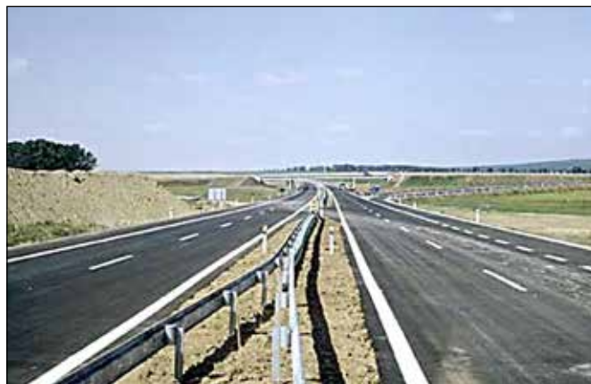
Dokončení úseku dálnice D1 mezi obcí Tučapy a Vyškovem včetně napojení na silnici R46 dne 30. července 1992.
